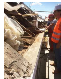
A minorita templom súlyosan károsodott tetőszerkezete
